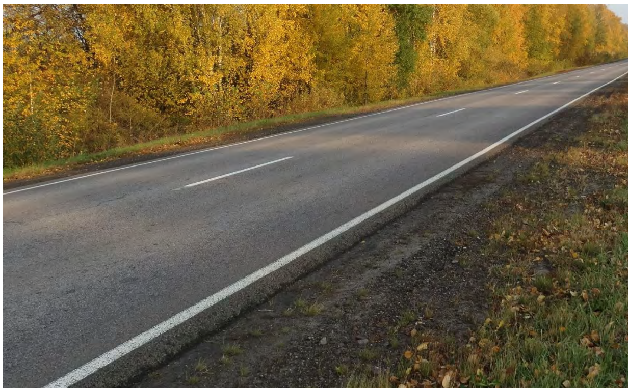
Рис.10. Просадка обочины относительно проезжей части дороги А-143 «Тамбов-Шацк»
