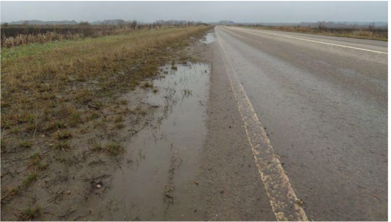
Рис.12. Просадка обочины относительно проезжей части дороги
