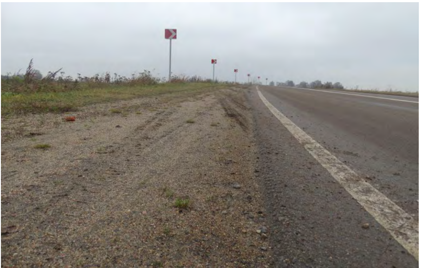
Рис.11. Отсутствие щебня при укреплении обочины.
