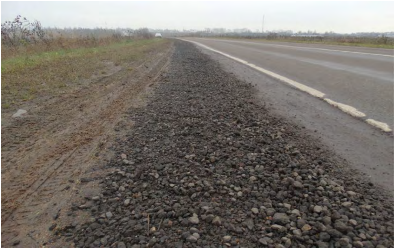
Рис.10. Состояние укрепления обочин на автомобильной дороге
